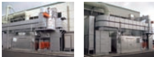
脱臭装置(九州工場)
